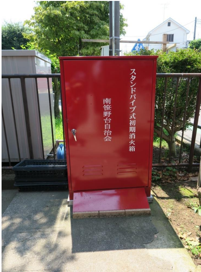
スタンドパイプ保管庫
