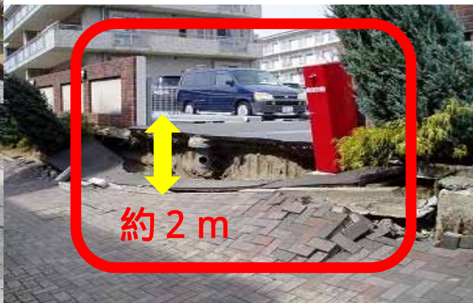
機械式立体駐車場の浮き上がり
