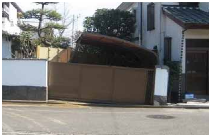
液状化による家屋の傾斜
