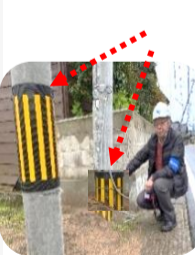
液状化で 沈んだ電柱
